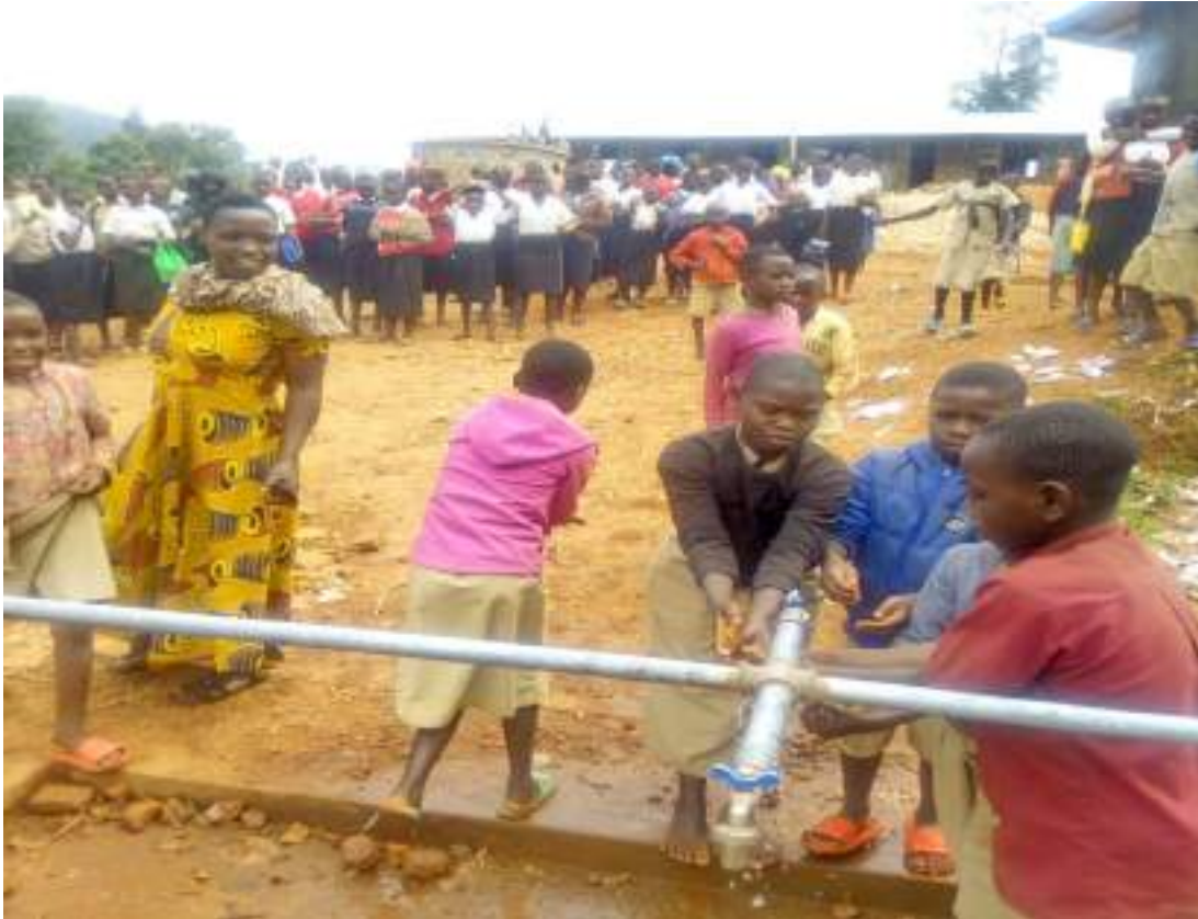
Robinet d'eau potable installée à l'ECOFO Cirisha
